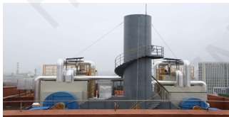
VOCs有机废气处理系统
