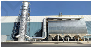
含尘废气处理系统
