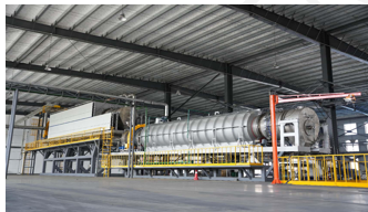
破碎电池回收智慧产线
